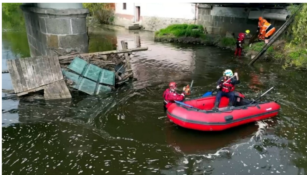
Odstranění naplavenin mostu 1371–1 Tábor – Čelkovice – motorový člun HZS
