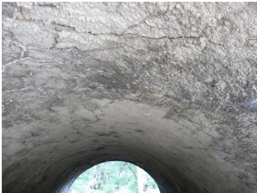
Obrázek 4 Nosná konstrukce – promočené spáry mezi nosíky s velmi oslabenou výztuží
